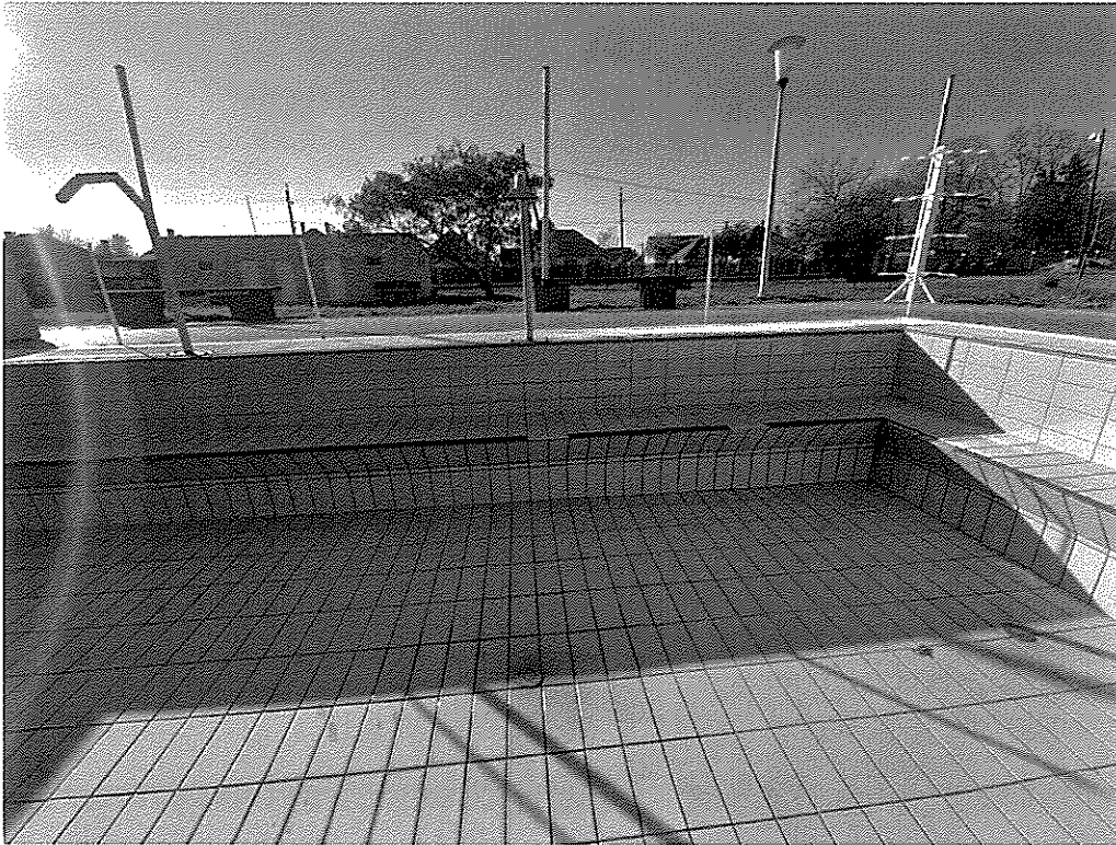
25. kép - pihenőmedence nyugati fala, repedések nem láthatók
