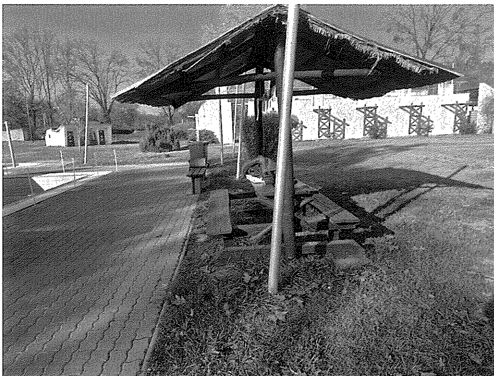
27. kép - pihenőpadról déli oldali fotó, a pad nyugati irányban is megbillent, talajon horpadás, süllyedés
