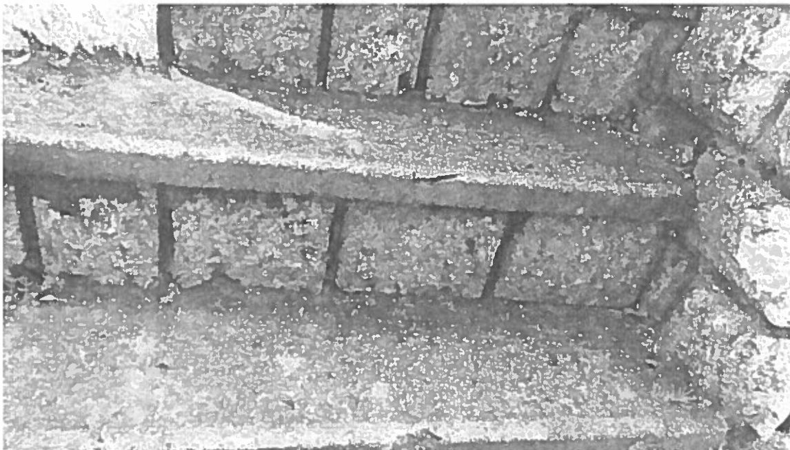
A köveken és a beton felületeken megtelepedtek az algák, mohák elszíneződéseket okozva
