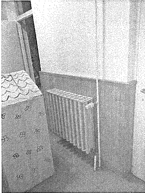
Radiátor és termofej
