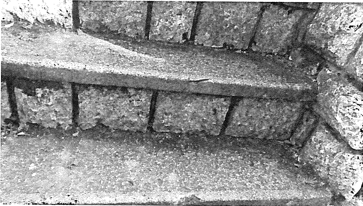
A köveken és a beton felületeken megtelepedtek az algák, mohák elszíneződéseket okozva
